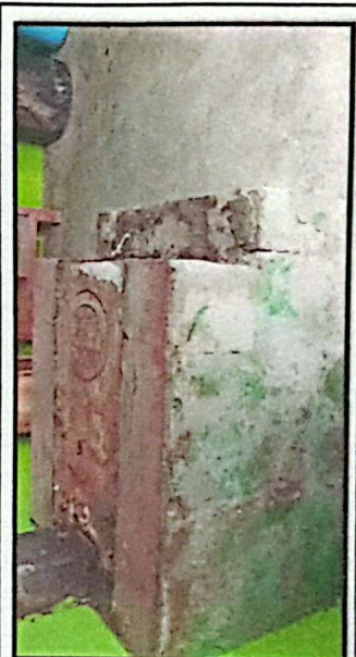
Foto 5: plancha en mal estado agrietadas
