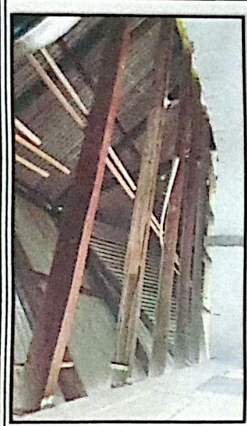
Foto 1: la madera en mal estado por la polilla
